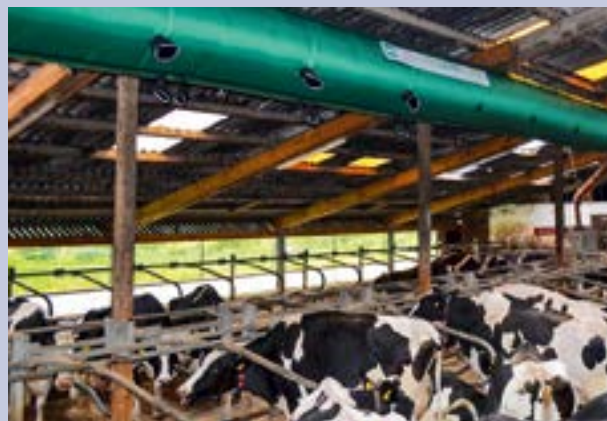
Auch im Kuhstall findet die Schlauchbelüftung Verwendung. Es sollte allerdings immer das Original installiert werden.
